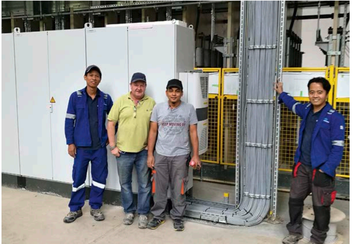
Baustellenleiter Norbert Reiter (2. v. l.) mit Artemio Suratos, Jismar Bin Desa und Bruno Kasimin (alle Siempelkamp Kuala Lumpur) während der Verkabelung und des IO-Checks auf der Baustelle Kronospan Veliko Tarnovo, Bulgarien
