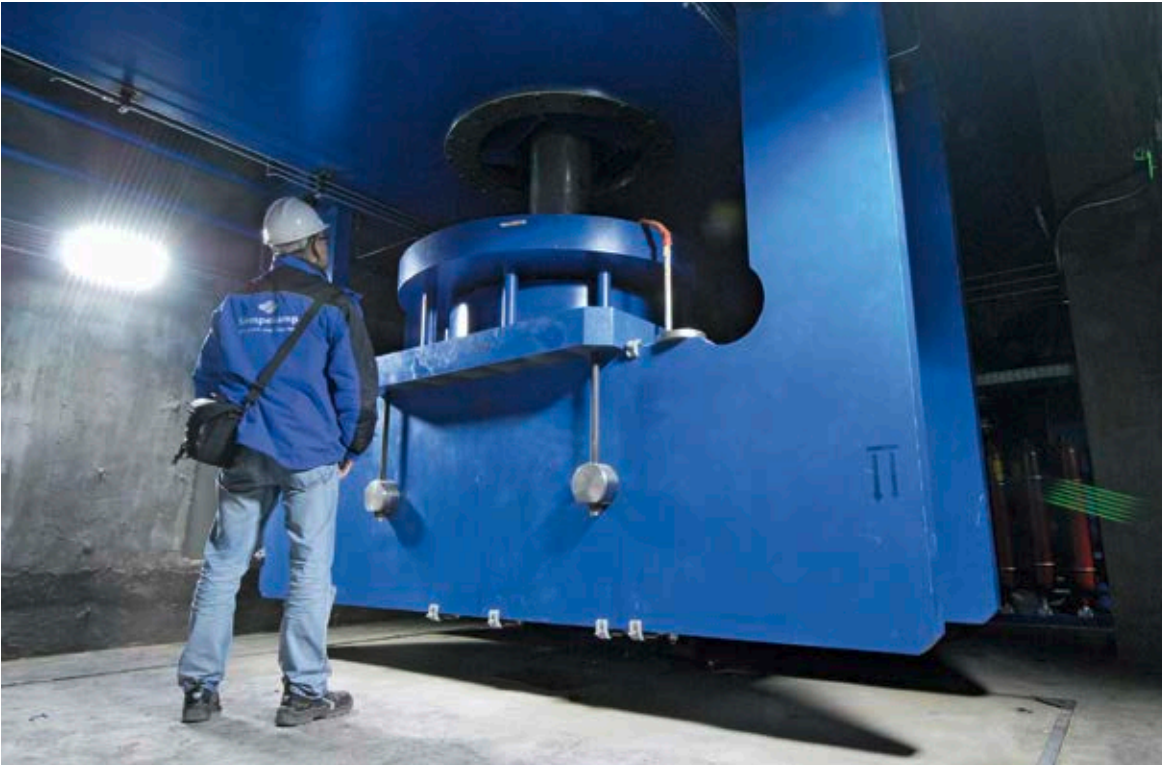
Externer unterflurig verbauter Ausstoßer
