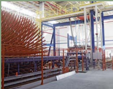
Kühl- und Abstapelanlage
