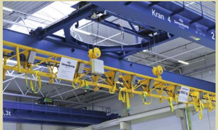
Mit der neuen Krananlage lassen sich die 28-Meter-Longteile sogar in der Halle problemlos um die eigene Achse drehen
