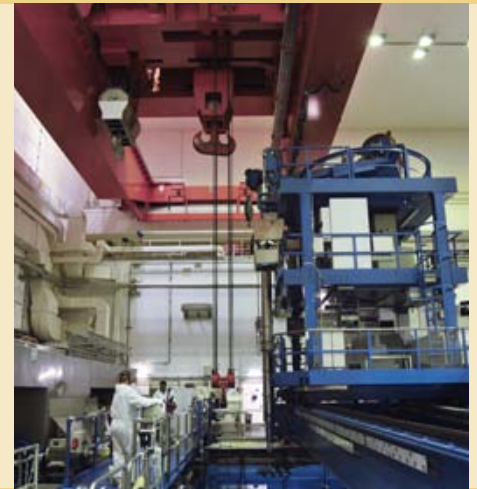
Die Krananlage im Reaktorgebäude modernisierte Siempelkamp
