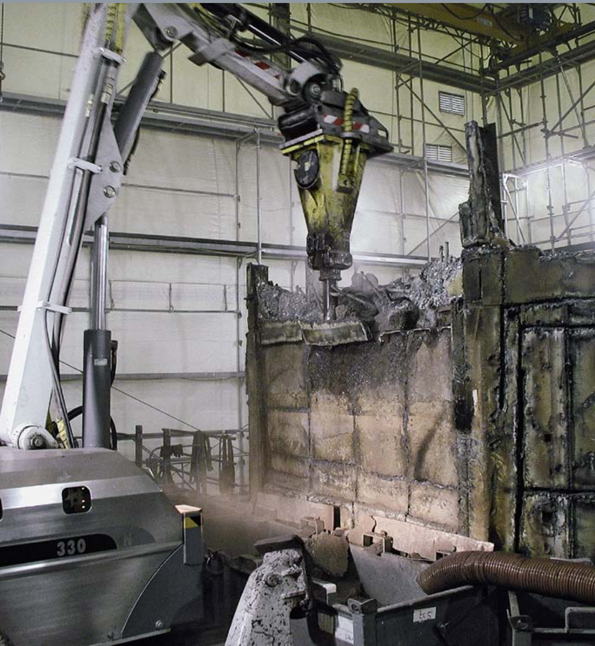
Der Abbruch von Komponenten eines Kernkraftwerks wirkt grob, muss aber von Anfang an präzise geplant werden
