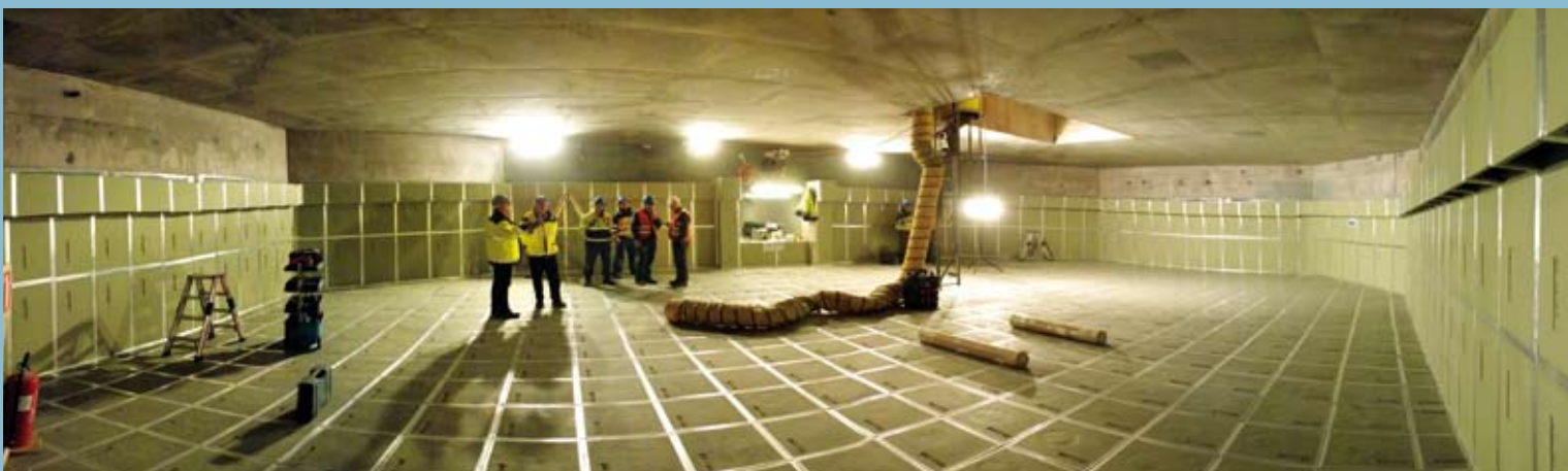
Der Spreading Room mit fertig installierter Kühlstruktur des Core Catchers
