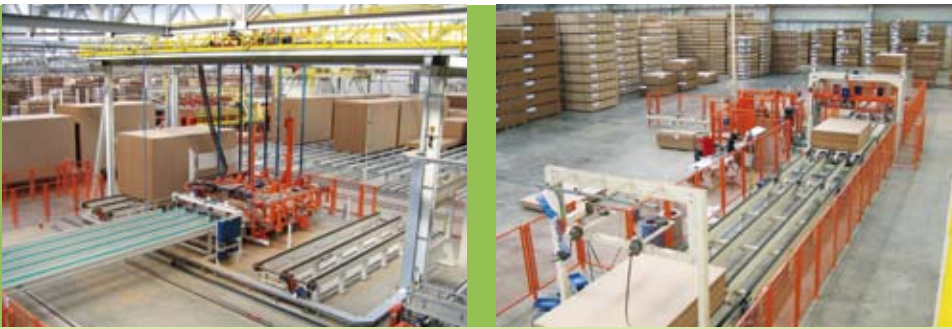
Links: Abstapelung und Verpackungslinie Unten: Duratex 77-m-Aufteilanlage und Kühl- und Abstapelanlage
