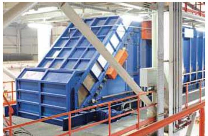
Seitenbesäumung der Fasermatte Austragsfront des Faserstreubunkers
